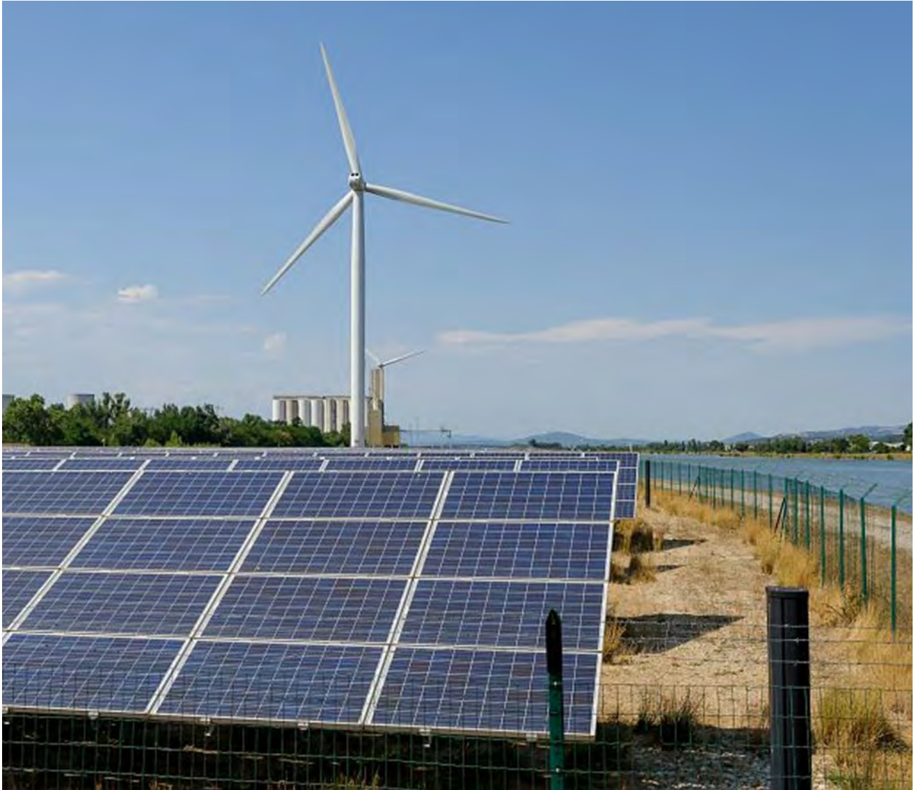
Parcs éolien et photovoltaïque de la Compagnie Nationale du Rhône © Arnaud Bouissou/Terra
