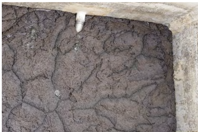
Bassin de décantation et de traitement des eaux usées © Bernard Suard/Terra
